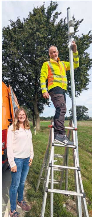
Greta Oberkirsch vom Team des Chief Digital Officers der Kreisverwaltung und Timm Rosenthal vom Kreisstraßenbauamt haben die vorgesehenen Standorte im Kreisgebiet mit der neuen Technik ausgestattet. Foto: Kreis Paderborn
