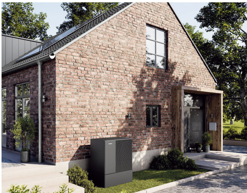
Bis zu 70 Prozent vom Staat: Die Förderung für den Umstieg auf eine Wärmepumpe ist aktuell so attraktiv wie noch nie. Foto: djd/Stiebel Eltron
